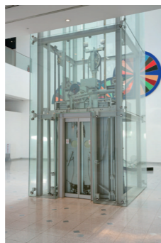
シースルーエレベーター 1階乗降口 *撮影：長岡浩司
